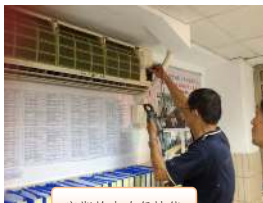
定期檢查冷氣性能
