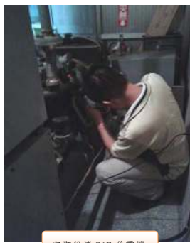
定期維護 BIF 發電機
